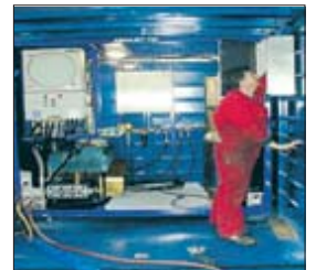
Abrajat montert i offshore 10' container Eexde-utførelse.
